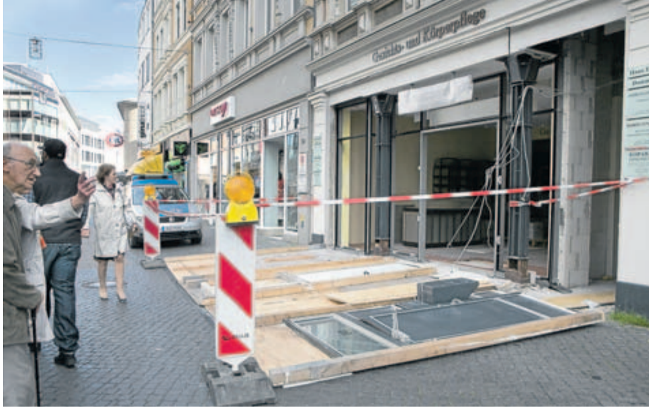
Die umgekippte Bauschutzwand am Samstag kurz nach dem Unglück.
